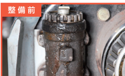
整備前 ホイール・シリンダのゴム部品が劣化し、液漏れしている状態
